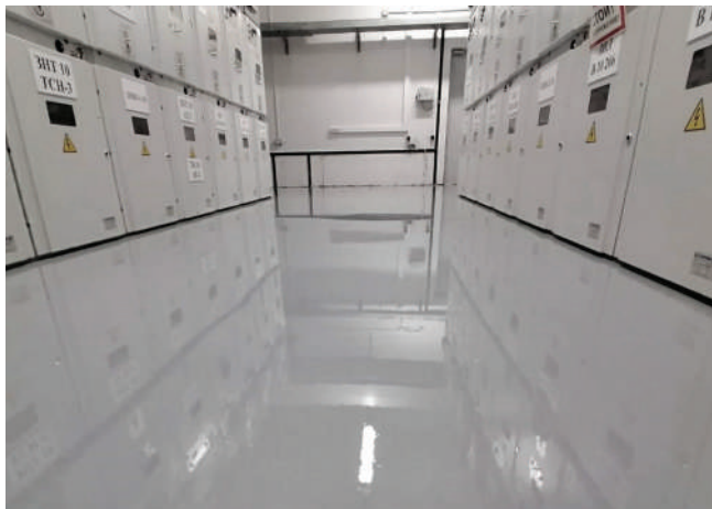
Подстанция Пахра, здание КРУЭ, МО, г. Домодедово, Краснодарская, 10
